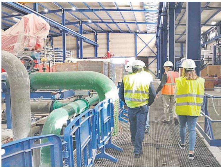
Interior de la desaladora de Mar de Alborán.
