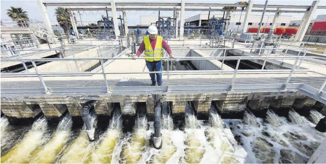
Instalaciones de la desalinizadora de El Prat, cerca de la desembocadura del Llobregat.
